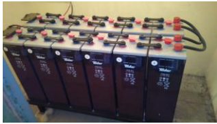
Ej sistema de baterías de alimentación
