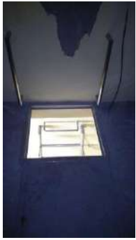
Vista de hueco sin trampilla en Faro de Roche
