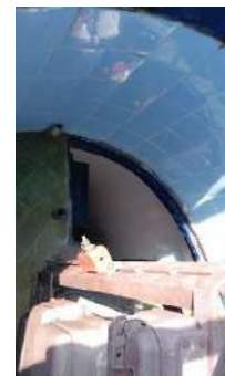
Vista de hueco sin trampilla en Faro de Rota
