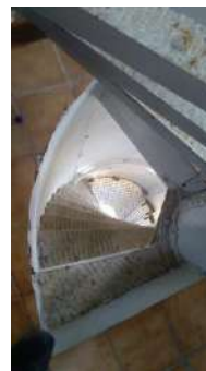
Vista de hueco sin trampilla en Faro de Cádiz
