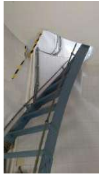
Vista de hueco sin trampilla en Faro de Trafalgar
