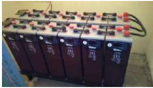
Ej sistema de baterías de alimentación
