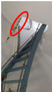
Vista de ascenso con riesgo de golpeo en Faro de Trafalgar
