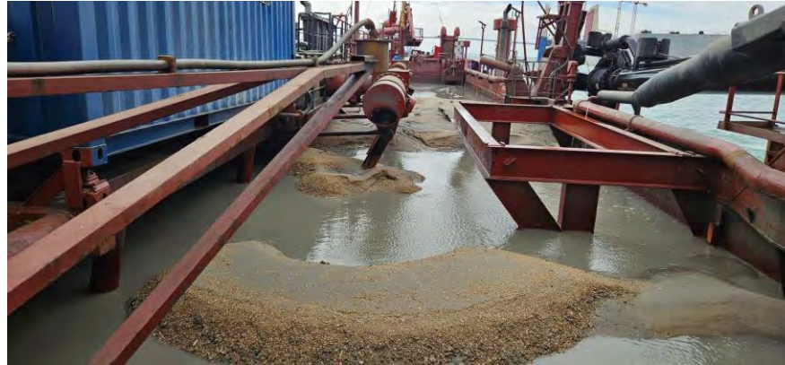
Figura 03 - Seguimiento y control arqueológico del dragado para la Fase II de la ampliación de la NTC, a bordo de la Viking R. Supervisión de la cántara tras la 2ª carga del turno. Detalle del tipo de sedimento extraído. Resultado positivo.
