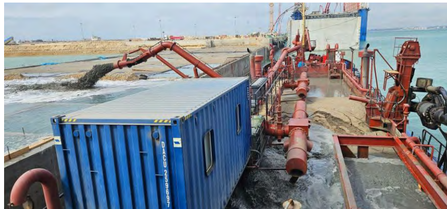
Figura 04 - Seguimiento y control arqueológico del dragado para la Fase II de la ampliación de la NTC, a bordo de la Viking R. Supervisión de la 3ª descarga del turno. Inicio relleno del cajón 02 por su cara externa.
