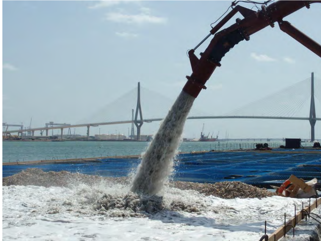
Figura 04 - Seguimiento y control arqueológico del dragado para la Fase II de la ampliación de la NTC, a bordo de la Viking R. Descarga con lanza para rellenar cajón 02 por la cara exterior.
