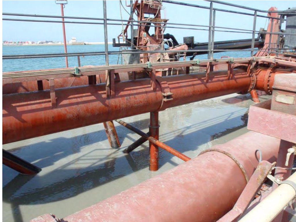
Figura 04 - Seguimiento y control arqueológico del dragado para la Fase II de la ampliación de la NTC, a bordo de la Viking R. Supervisión de la cántara tras la 2ª carga del turno, detalle del tipo de sedimento (fangos, limos arenosos y piedras). Resultado negativo.
