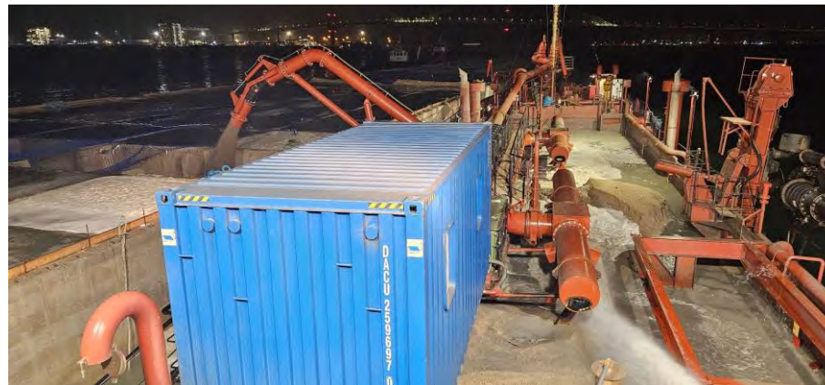
Figura 04 - Seguimiento y control arqueológico del dragado para la Fase II de la ampliación de la NTC, a bordo de la Viking R. Supervisión de la 1ª descarga del turno. Relleno del cajón 01 por su cara interna. área de vertido.
