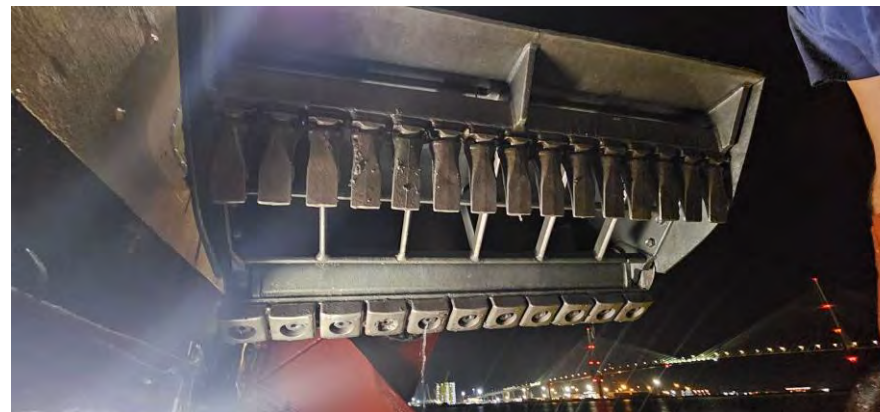
Figura 02 - Seguimiento y control arqueológico del dragado para la Fase II de la ampliación de la NTC, a bordo de la Viking R. Revisión de la limpieza de la cabeza de succión al finalizar la 1ª carga del turno. Resultado negativo.
