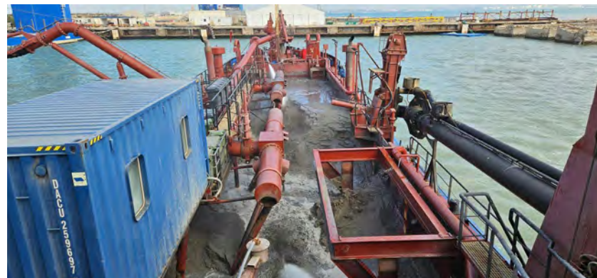
Figura 04 - Seguimiento y control arqueológico de la Fase II de la ampliación de la NTC, a bordo de la Viking R. Supervisión de la primera descarga realizada a través de tubería para el relleno de la dársena.
