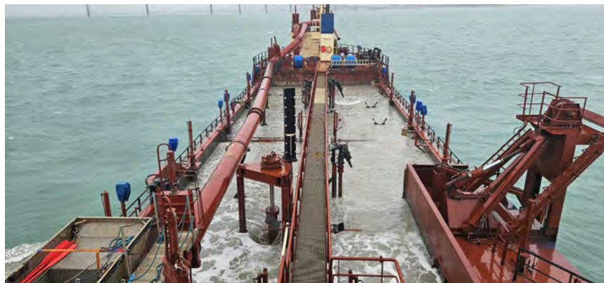
Figura 05 - Seguimiento y control arqueológico de la Fase II de la ampliación de la NTC, a bordo de la Idun R. Supervisión de las labores de dragado, trazado, tipo de sedimento, posición de la draga en la zona de reviro y frente de cajones de la NTC durante la 1ª carga iniciada en el turno.
