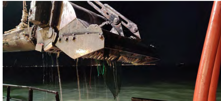
Figura 03 - Seguimiento y control arqueológico del dragado a bordo de la Viking R para la fase II de la ampliación de la NTC. Revisión del cabezal lleno de redes y material de desecho.
