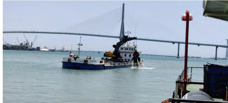
Figura 03 - Seguimiento y control arqueológico de la Fase II de la ampliación de la NTC. Omarsub trabajando para quitar las rocas del fondo.
