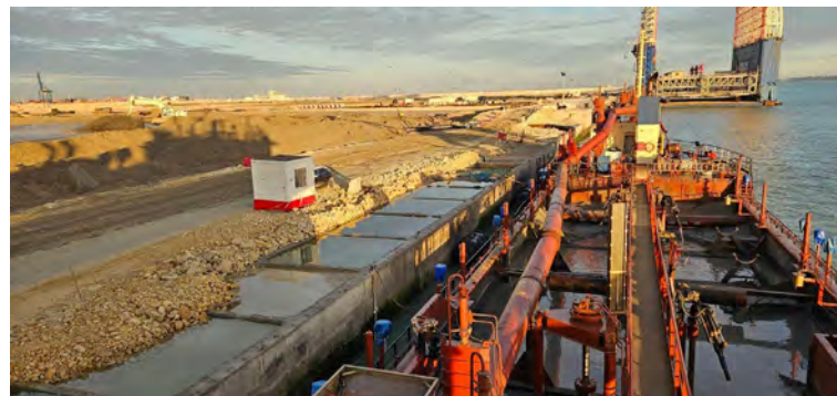
Figura 04 - Seguimiento y control arqueológico de la Fase II de la ampliación de la NTC, a bordo de la Idun R. Supervisión de la 1ª descarga realizada en el turno a través de tubería para el relleno de la dársena.
