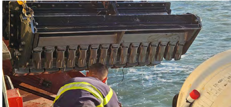
Figura 09 - Seguimiento y control arqueológico del dragado para la Fase II de la ampliación de la NTC, a bordo de la Viking R. Revisión de la cabeza de succión tras la 3ª carga completada en el turno. Resultado negativo.
