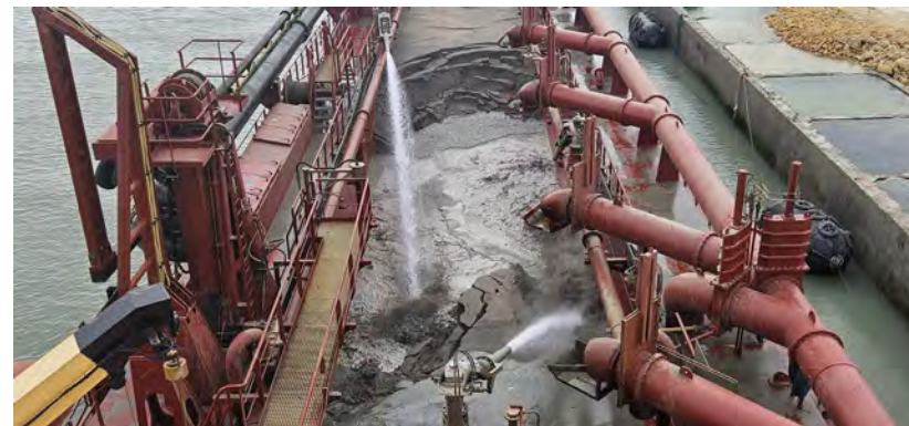
Figura 04 - Seguimiento y control arqueológico de la Fase II de la ampliación de la NTC, a bordo de la Brage R. Supervisión de la 2ª descarga realizada en el turno a través de tubería para el relleno de la dársena.
