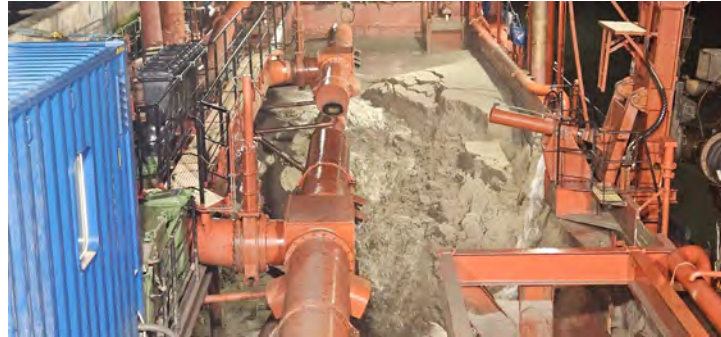
Figura 03 - Seguimiento y control arqueológico de la Fase II de la ampliación de la NTC, a bordo de la Viking R Supervisión de la 1ª descarga realizada en el turno a través de tubería para el relleno de la dársena.
