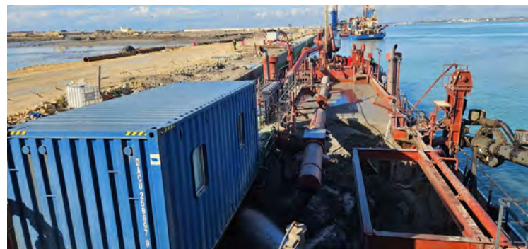
Figura 04 - Seguimiento y control arqueológico de la Fase II de la ampliación de la NTC, a bordo de la Viking R. Supervisión de la 1ª descarga realizada en el turno a través de tubería para el relleno de la dársena.
