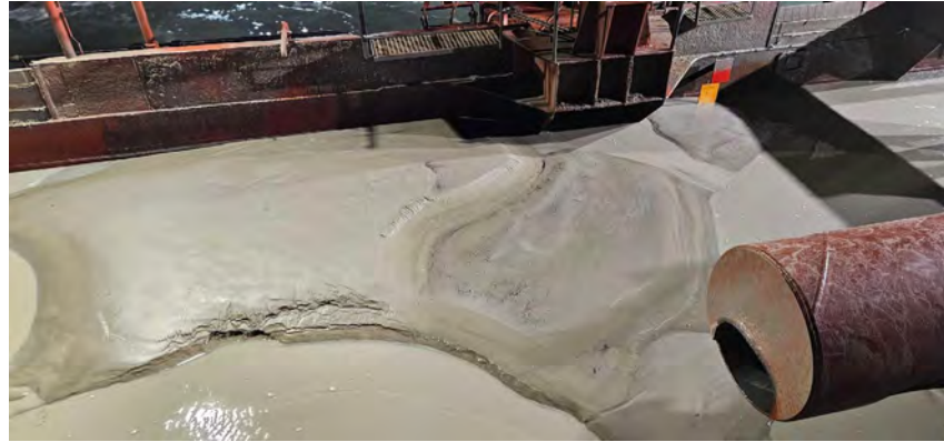
Figura 09 - Seguimiento y control arqueológico del dragado para la Fase II de la ampliación de la NTC, a bordo de la Viking R. Supervisión de la cántara tras la 3ª carga completada. La cantidad de agua mantenida a bordo no permite la revisión del material extraído. Resultado negativo.
