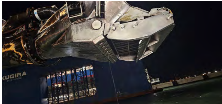
Figura 09 - Seguimiento y control arqueológico del dragado para la Fase II de la ampliación de la NTC, a bordo de la Viking R. Revisión de la cabeza de succión tras la 3ª carga completada en el turno. Resultado negativo.
