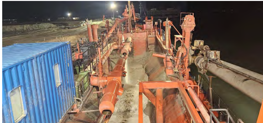
Figura 04 - Seguimiento y control arqueológico de la Fase II de la ampliación de la NTC, a bordo de la Viking R. Supervisión de la 2ª descarga realizada en el turno a través de tubería para el relleno de la dársena.
