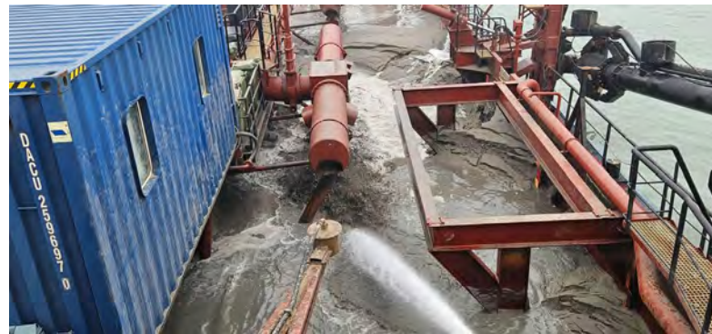
Figura 04 - Seguimiento y control arqueológico de la Fase II de la ampliación de la NTC, a bordo de la Viking R. Supervisión de la 2ª descarga realizada en el turno a través de tubería para el relleno de la dársena.
