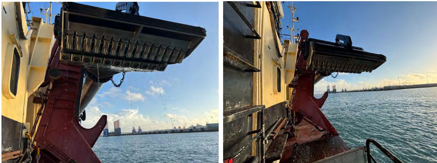
Figura 01 y 02 - Seguimiento y control arqueológico del dragado para la Fase II de la ampliación de la NTC, a bordo de la Viking R. Revisión de la cabeza de succión tras la 1ª carga del turno, completada. Resultado negativo.
