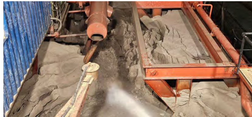
Figura 14 - Seguimiento y control arqueológico de la Fase II de la ampliación de la NTC, a bordo de la Viking R. Supervisión de la 5ª descarga realizada en el turno a través de tubería para el relleno de la dársena.
