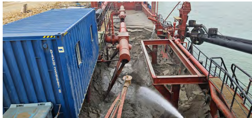
Figura 08 - Seguimiento y control arqueológico de la Fase II de la ampliación de la NTC, a bordo de la Viking R. Supervisión de la 3ª descarga realizada en el turno a través de tubería para el relleno de la dársena.
