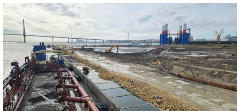
Figura 04 - Seguimiento y control arqueológico de la Fase II de la ampliación de la NTC, a bordo de la Brage R. Supervisión de la 1ª descarga realizada en el turno a través de tubería para el relleno de la dársena.
