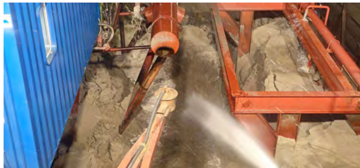
Figura 16 - Seguimiento y control arqueológico de la Fase II de la ampliación de la NTC, a bordo de la Viking R. Supervisión de la 4ª descarga realizada en el turno a través de tubería para el relleno de la dársena.
