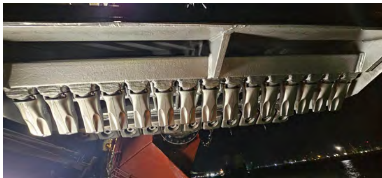
Figura 01 - Seguimiento y control arqueológico del dragado para la Fase II de la ampliación de la NTC, a bordo de la Viking R. Revisión de la limpieza de la cabeza de succión tras la primera carga completada en el turno. Material de desecho. Resultado negativo.
