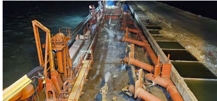
Figura 01 - Seguimiento y control arqueológico de la Fase II de la ampliación de la NTC, a bordo de la Brage R Supervisión de la 1ª descarga realizada en el turno a través de tubería para el relleno de la dársena.
