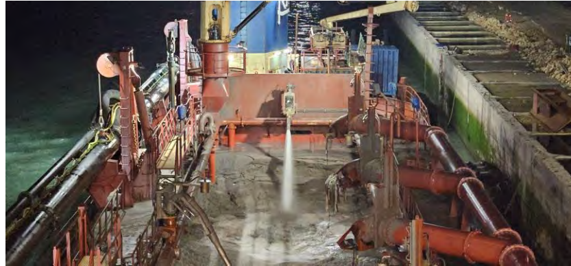
Figura 03 - Seguimiento y control arqueológico de la Fase II de la ampliación de la NTC, a bordo de la Brage R Supervisión de la 1ª descarga realizada en el turno a través de tubería para el relleno de la dársena.
