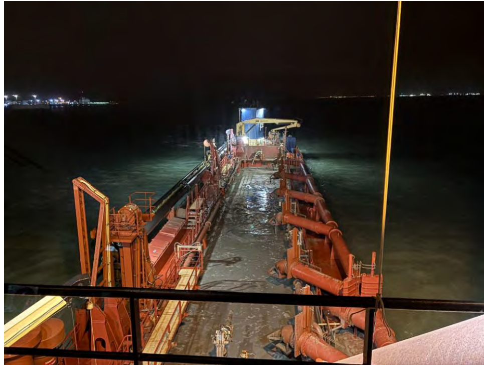
Figura 03 - Seguimiento y control arqueológico del dragado para la Fase II de la ampliación de la NTC, a bordo de la Brage R. Revisión de la cántara tras la 3ª carga del turno.
