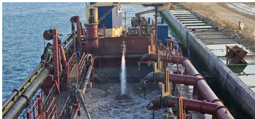
Figura 08 - Seguimiento y control arqueológico de la Fase II de la ampliación de la NTC, a bordo de la Brage R. Supervisión de la 3ª descarga realizada en el turno a través de tubería para el relleno de la dársena.
