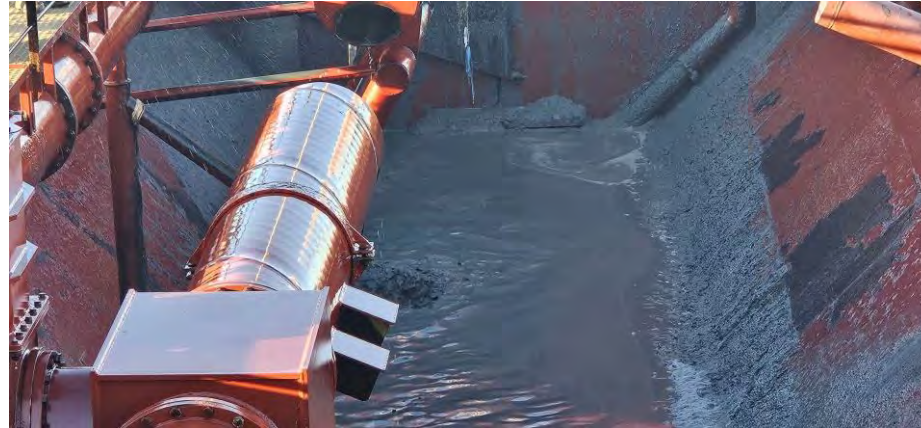
Figura 09 - Seguimiento y control arqueológico de la Fase II de la ampliación de la NTC, a bordo de la Viking R Supervisión de la 2ª descarga realizada en el turno a través de tubería para el relleno de la dársena.
