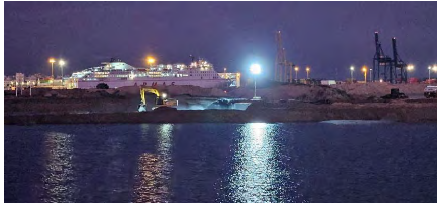
Figura 05 - Seguimiento y control arqueológico de la Fase II de la ampliación de la NTC, a bordo de la Viking R Supervisión de la 4ª descarga realizada en el turno a través de tubería para el relleno de la dársena.
