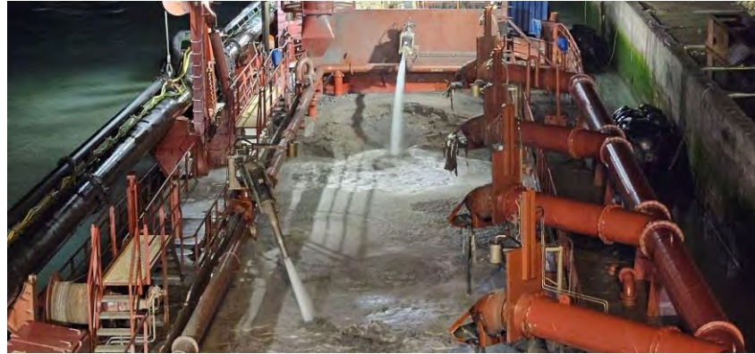
Figura 07 - Seguimiento y control arqueológico de la Fase II de la ampliación de la NTC, a bordo de la Brage R Supervisión de la 2ª descarga realizada en el turno a través de tubería para el relleno de la dársena.
