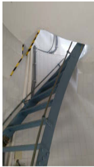
Vista de hueco sin trampilla en Faro de Trafalgar
