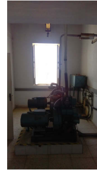
Vista de bancada de generadores Faro de Roche
