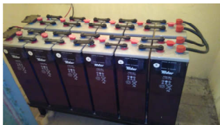
Ej sistema de baterías de alimentación
